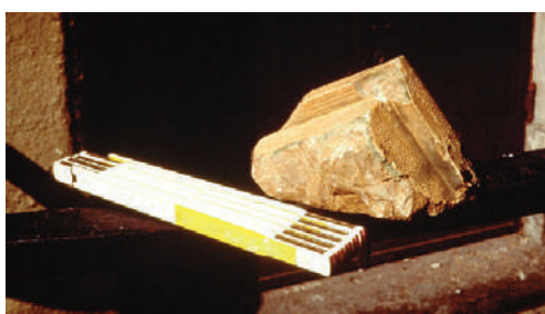
Fig. 12-14 - Firenze, Palazzo Davanzati: vista generale, area collassata nel paramento murario e frammento di pietraforte.
