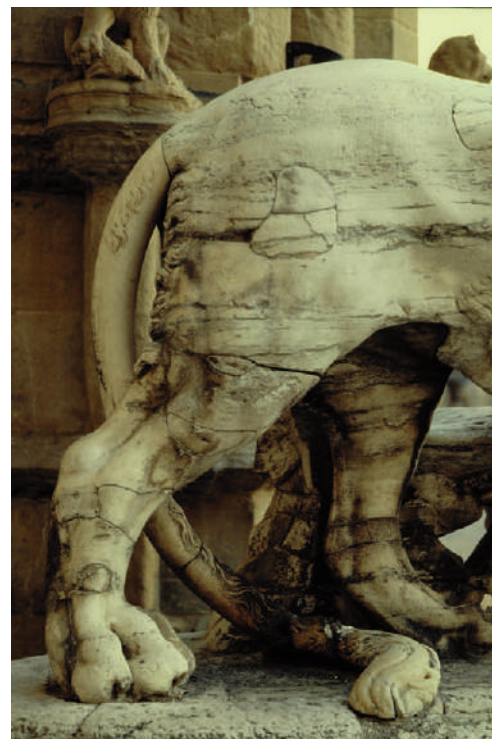
Figg. 4, 5 - Firenze, Loggia dei Lanzi: veduta generale e dettaglio dello stato di conservazione di una scultura.
