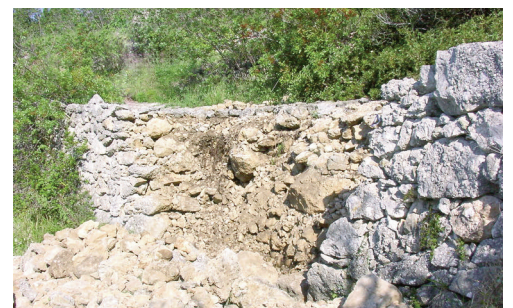
Fig. 7 - Muro di contenimento con il solo paramento esterno in pietra a secco, posteriormente legato con la terra.
