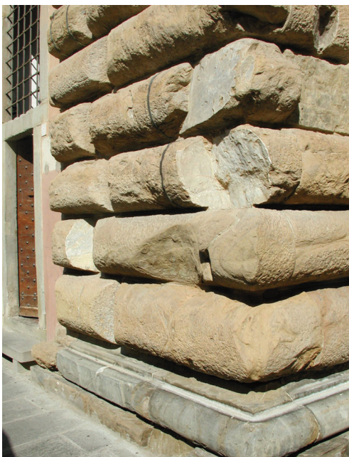
Figg. 2, 3 - Firenze, Palazzo Uguccioni, vista generale e dettaglio del degrado lapideo.
