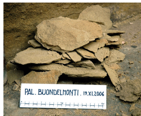
Fig. 15, 16 - Firenze, Palazzo Buondelmonti e frammenti di pietraforte collassata.
